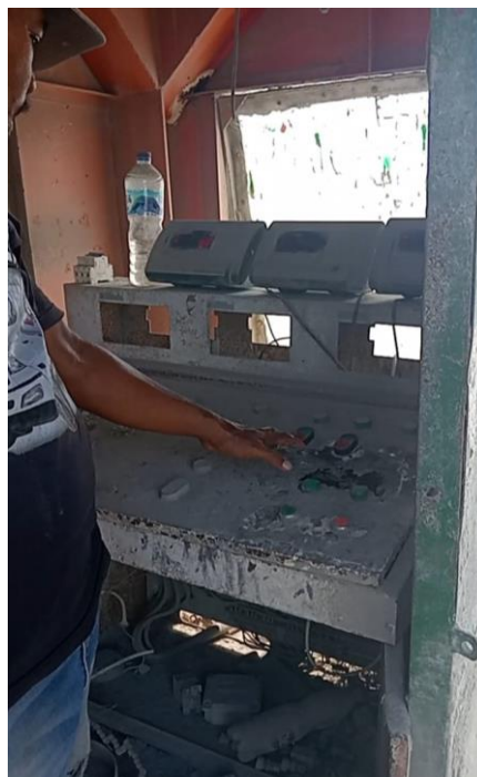
Gambar 1.1 Panel control yang tidak dirawat dengan baik
