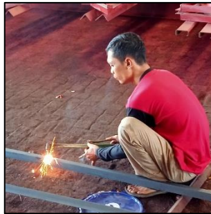
Gambar 1.3 Pekerja tidak menggunakan APD
