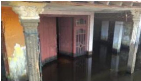
Gambar 1.4 Kondisi Rumah Warga di Pekalongan
